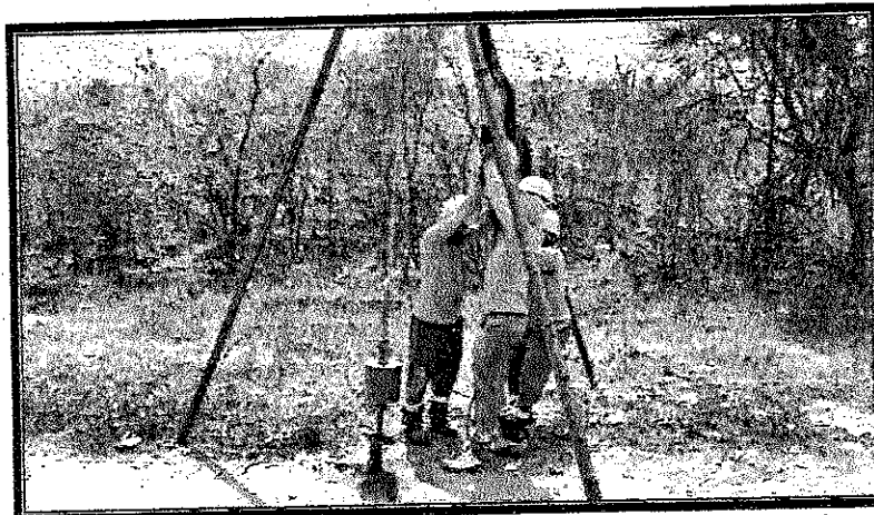
Foto 2 – Mais uma sondagem sendo executada no trecho onde será construída a passagem molhada na zona rural de Forquilha/CE
