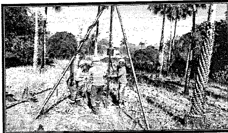
Foto 2 – Mais uma sondagem sendo executada no trecho onde será construída a passagem molhada na zona rural de Forquilha/CE
